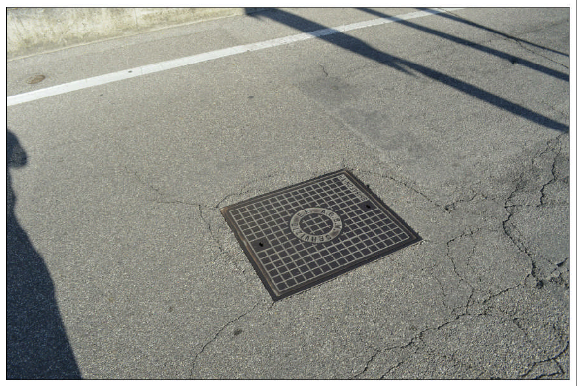
FOTO 11 - vista chiusino quota coposaldo - incrocio tra via Carnia, via Cason e via Brigata Aosta
